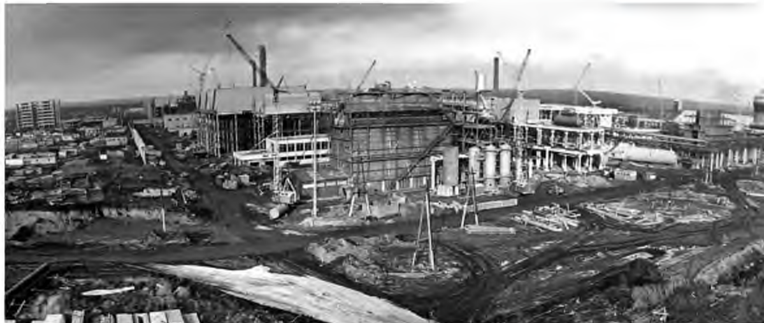
Было: площадка Тольяттиазота в ноябре 1977 года. В левой части фото мы видим новое здание заводоуправления. Вокруг него кипит стройка. На переднем плане – будущий второй агрегат аммиака. Слева от него уже возводят четвёртый агрегат, а чуть дальше справа видны гранбашня карбамида, склад готовой продукции и котельная
